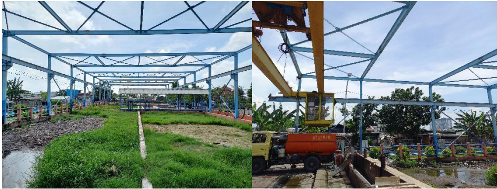
Gambar 6. Kondisi Eksisting Unit SSC
